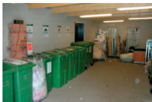
AirMaid® em Salas de Resíduos
